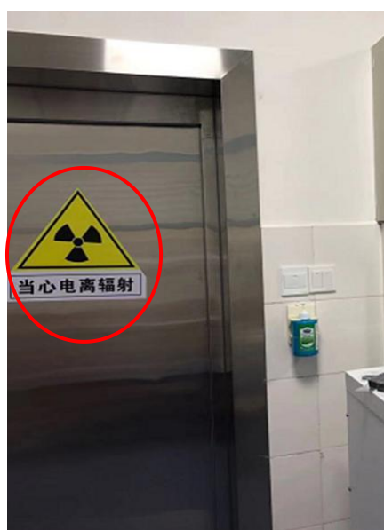
图 4-4 本项目控制室防护门当心电离辐射警示标志
