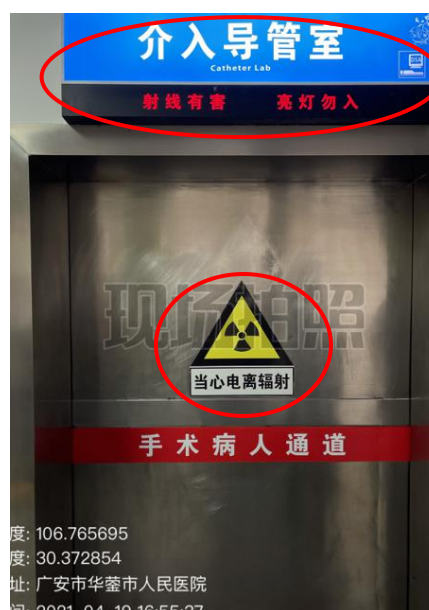
图 4-5 本项目 DSA 机房防护门当心电离辐射警示标志及工作状态指示灯
