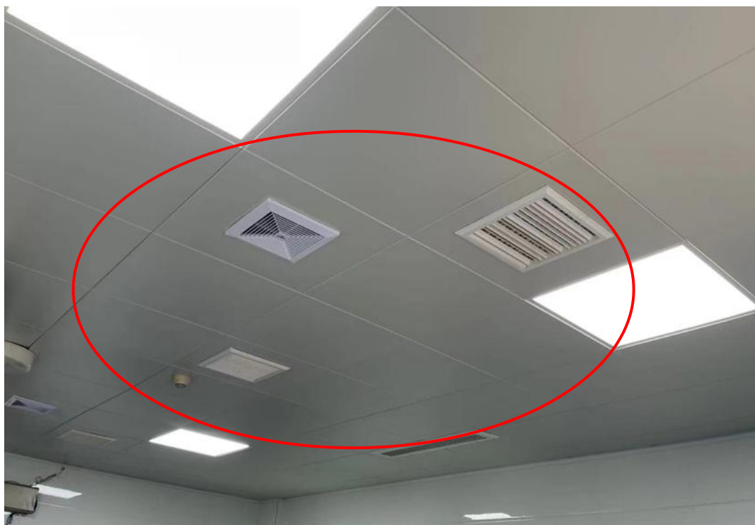
图 4-11 机房内通排风系统
