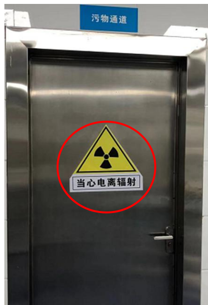
图 4-3 本项目污物门当心电离辐射警示
